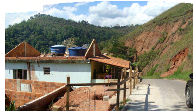
Viarío R-A. Situación del ascenso, viviendas y ladera deforestada
