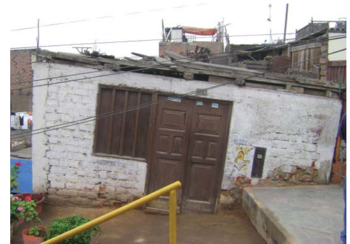
Vivienda con asentamientos.
